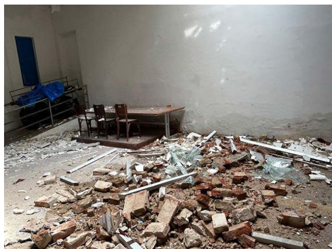
Fig. 03 – Destroços acumulados no interior do Anfiteatro como consequência do desmoronamento do teto e outras partes.
